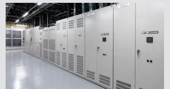
納入したUPS・配電盤
