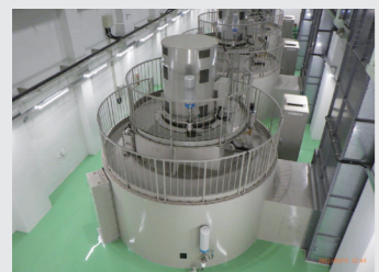
五ヶ瀬川発電所 (宮崎県 旭化成株式会社様)
