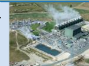
地熱発電設備
