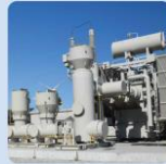
変電 システム
