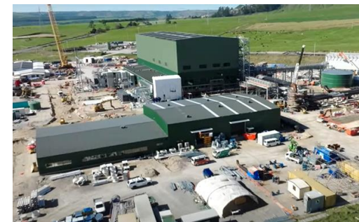
ニュージーランド タウハラ地熱発電所 184MW
