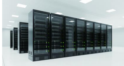
データセンター
