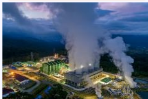
地熱発電設備
