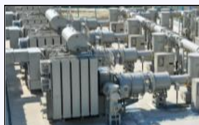
(受変電設備) 産業変電
