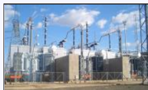
(大容量変圧器) 電力変電
