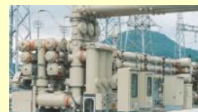
GIS (開閉装置)
