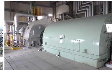
蒸気タービン・発電機
