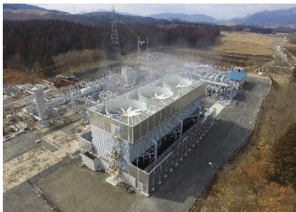
地熱発電所 (ORC式)
