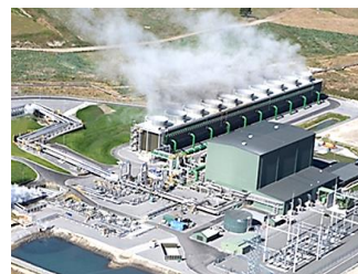
地熱発電所 (フラッシュ式)
