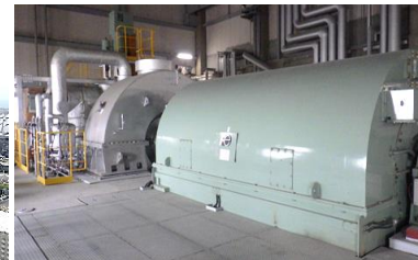
蒸気タービン・発電機
