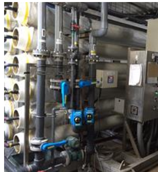
排水回収システム
