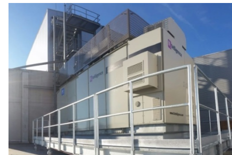
Wolf Butterback KG様 冷凍倉庫向け100kW燃料電池 (2016年竣工)
