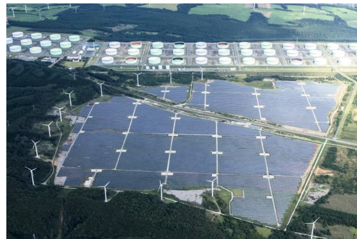
双日・未来創電上北六ヶ所(株)様 上北六ヶ所太陽光発電所 (EPC案件 AC 51MW) 2017年3月納入
