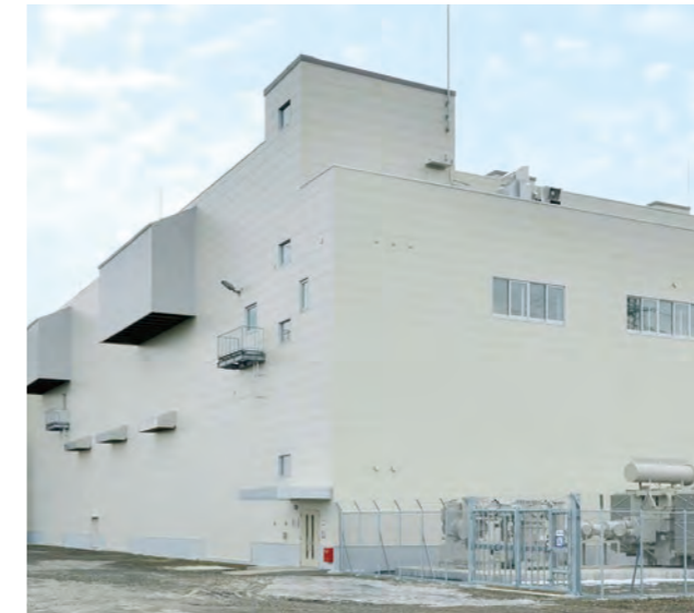
南早来変電所 (左: 建屋外観 右: 建屋内の当社製パワーコンディショナ)
