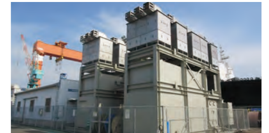
陸上電力供給システム(外観)
