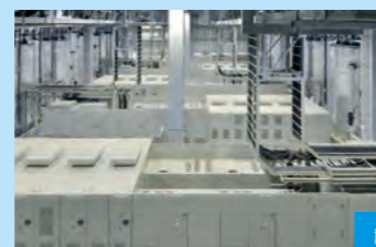
Case2 電力系統向け 蓄電池システム
