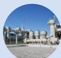
変電システム
