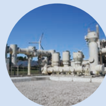
変電システム
