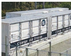
蓄電システム
