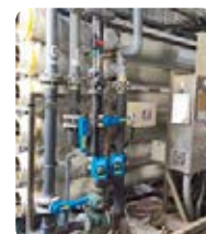
排水回収システム
