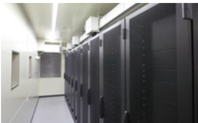
データセンター
