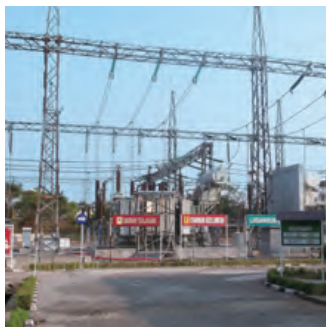
工業団地の受変電設備
