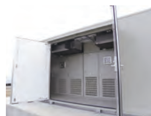
門司発電所内の屋外コンテナに入ったパワーコンディショナ
