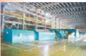
タービン発電機
