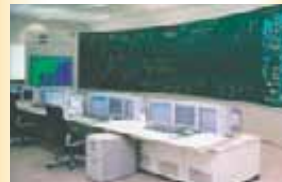
電力監視制御システム
