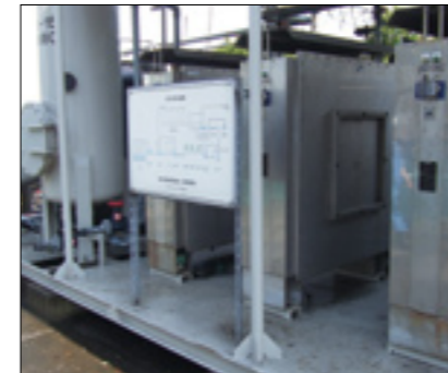
川崎工場の地下水くみ上げ浄化装置
