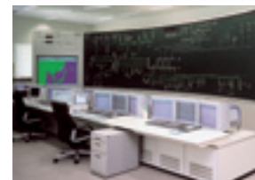
電力監視装置
