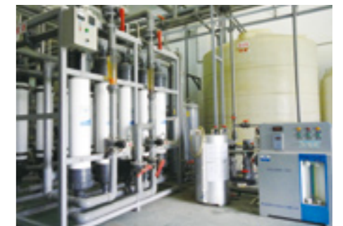
排水処理装置
