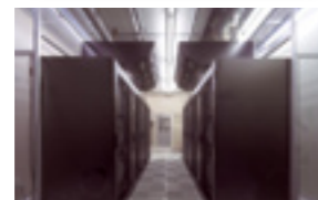
局所空調システム
