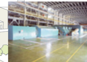
火力発電設備
