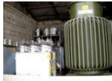
PCB使用機器の保管状況
