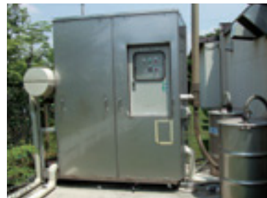
安曇富士のVOC(溶剤)脱気処理装置
