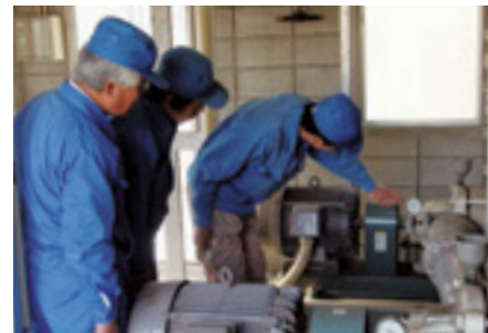
送水ポンプ省エネ診断
