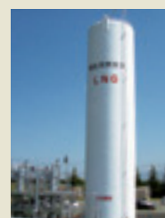
LNG(液化天然ガス)タンク (2008年3月完成)
