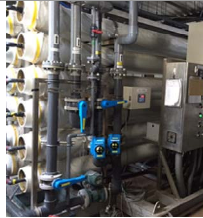
排水回収システム
