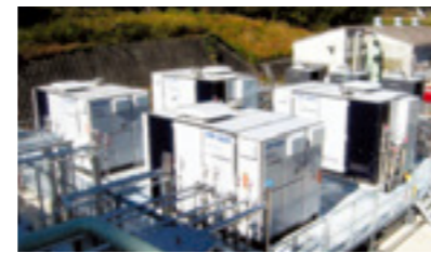
下水処理場に納入されている燃料電池発電システム
