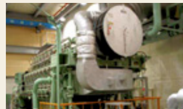
コージェネレーションシステム
