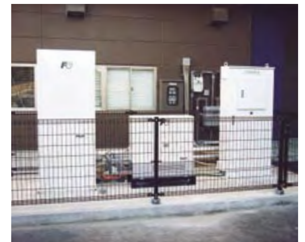
伊都キャンパス内に設置された固体高分子形燃料電池コージェネレーションシステム
