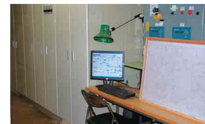
新たに導入したRO方式の純水製造装置
