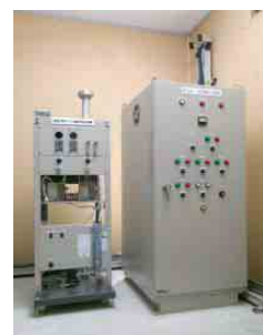
採用されたオゾン設備
