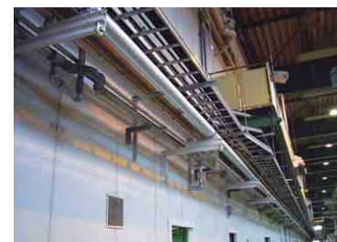
短縮された暖房用蒸気配管長
