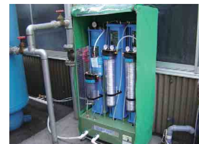
導入したコンプレッサードレンの廃液処理装置
