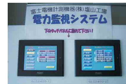
工場玄関に設置された「電力監視システム」のタッチパネル
