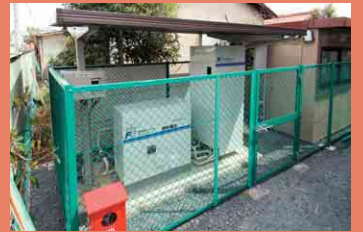
工業高等専門学校の教員宅への設置例
