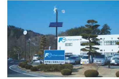
看板照明に利用している太陽光・風力発電システム
