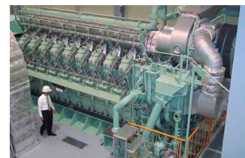
発電効率43.5%の希薄燃焼・高効率ガスエンジン(天然ガス専焼)
