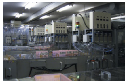
製造ラインにインバータを設置し、電力使用量を削減(秩父富士)
