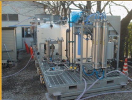
実証実験中の排水回収再利用プラント(富士電機デバイステクノロジー・松本事業所)
