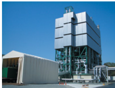
三重ごみ固形燃料発電所ボイラ
