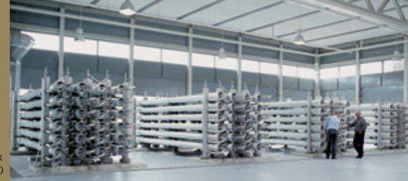
X-Flow社の膜ろ過システム (オランダ・HeemsKerk浄水場での1日の処理量は6万トン)
