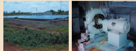
太陽光発電システム（100kW） （左）とマイクロ水力発電装置 （25kW）（右）
