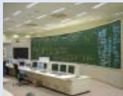
監視制御システム 東北電力における技術センター制御所システムの統合化を推進し、運用の効率化と高度化の実現をサポートしています。
