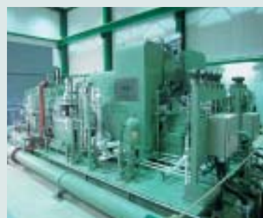
蒸気タービン発電機設備
