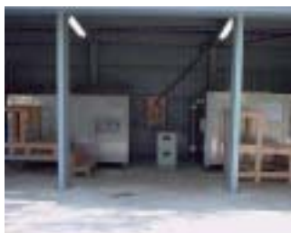
生ごみのコンポスト化設備(東京事業所)
