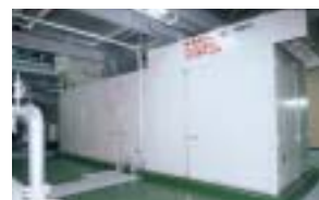
5,000kWガスタービン・コージェネレーション設備
