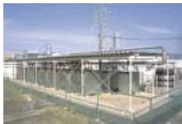
地下水浄化装置(三重事業所)
