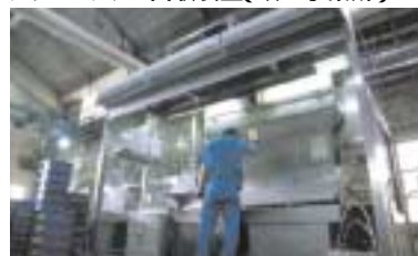
電磁開閉器の部品洗浄工程に設置されたジクロロメタンの回収フード。大気排出だけでなく、作業者の安全衛生にも配慮した設計になっています。
