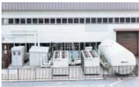
氷蓄熱システム設置例
