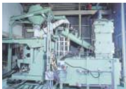
誘導加熱式乾留装置
