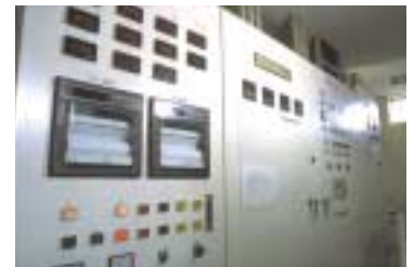
水質監視装置(松本事業所)
