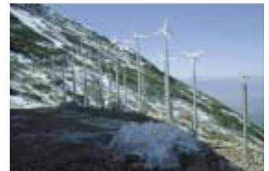
電力供給が困難な山岳部でのハイブリッド発電事例
