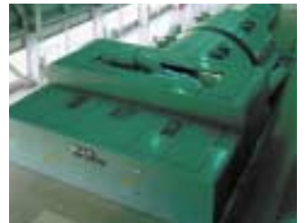
火力発電設備
